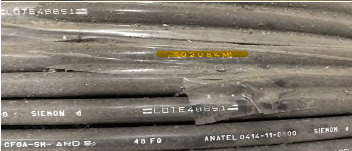
L02/03 Bobina cabo fibra ótica - 2.084 metros
